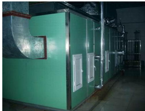
图 5-29 空调通风机组
